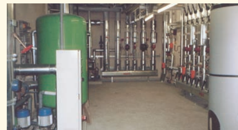
Heizzentrale Berufsschule Chemnitz
